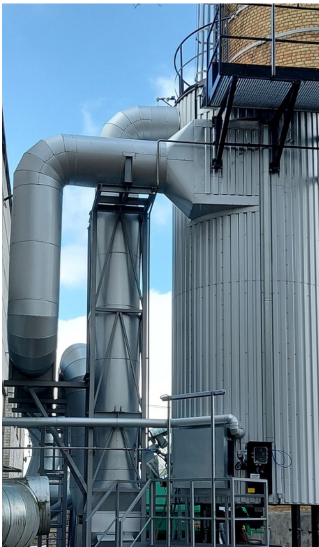
(Kėdainių ŠTR Akademijos katilinės dūmų valymo filtrai)
