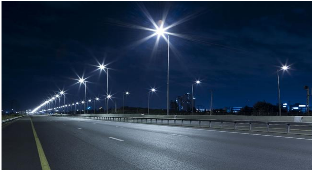
11.2 pav. Panevėžio miesto gatvių apšvietimo tinklų modernizavimas
